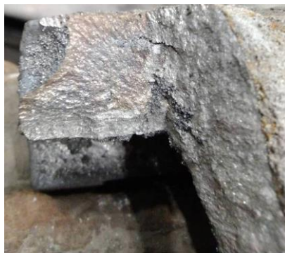
Рисунок 6 – Дефекты в узлах сопряжения в секции ГСК (место отбора пробы №1)
